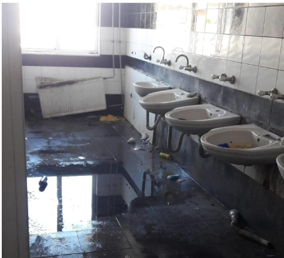
De sanitære anlæg i Harmanli er i en menneskeuværdig tilstand.
